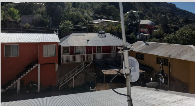
Instalación de AP6-Pro Outdoor en Ocampo
