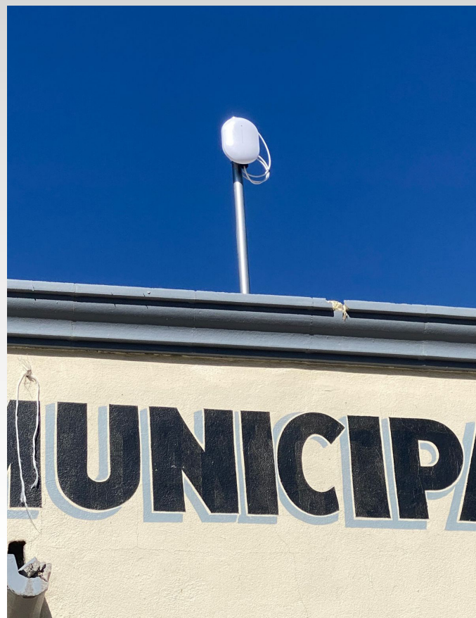
Instalación de AP6-Pro Outdoor en Huejotitán
